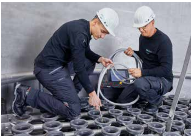
Medición con sonda en la cámara de aire limpio: medición, análisis y evaluación del comportamiento del flujo en condiciones de funcionamiento.
